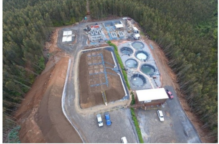
Proyecto de tierras raras en el Fundo El Cabrito, comuna de Penco, Región del Biobío.
