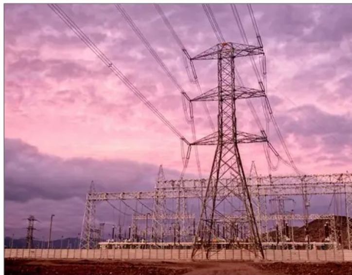
La línea de transmisión eléctrica Cardones-Polpaico sufrió dos retrasos por los conflictos que tuvo con comunidades vecinas a las instalaciones.
